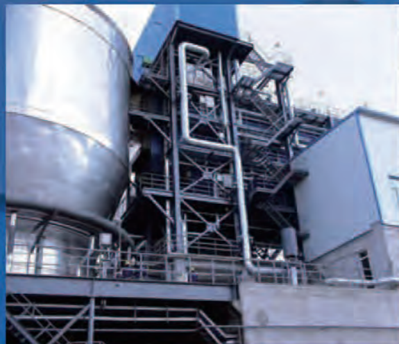
赤峰林东余热锅炉
