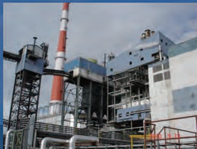
印度德里巴 10 万吨铅厂余热锅炉
